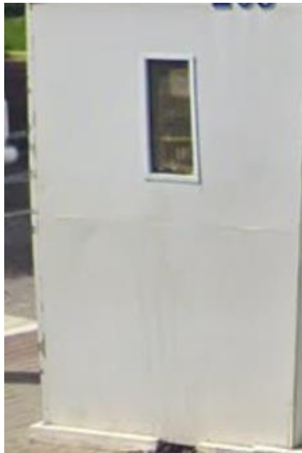
CAIXA DE MEDIÇÃO
